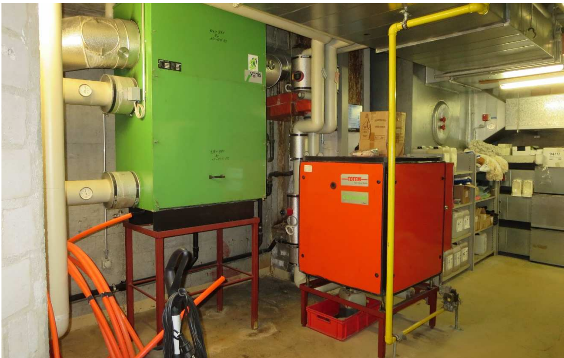
bestehende Hautechnik im Untergeschoss: weitgehender Ersatz
